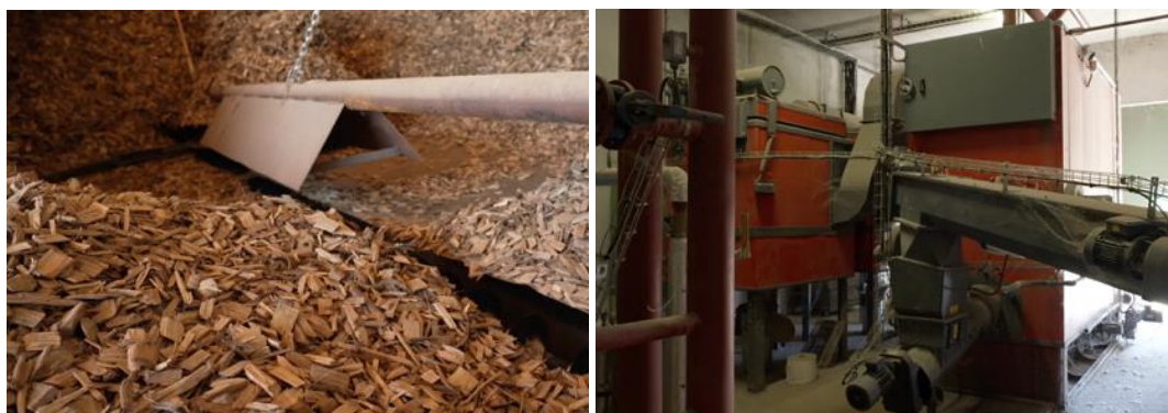
Figure 8 : chaudière à biomasse (plaquettes bois)
